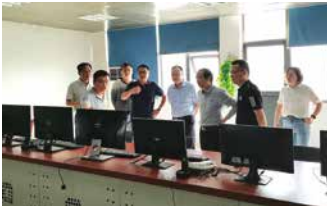
查看小仓房污水厂中控室运营数据
