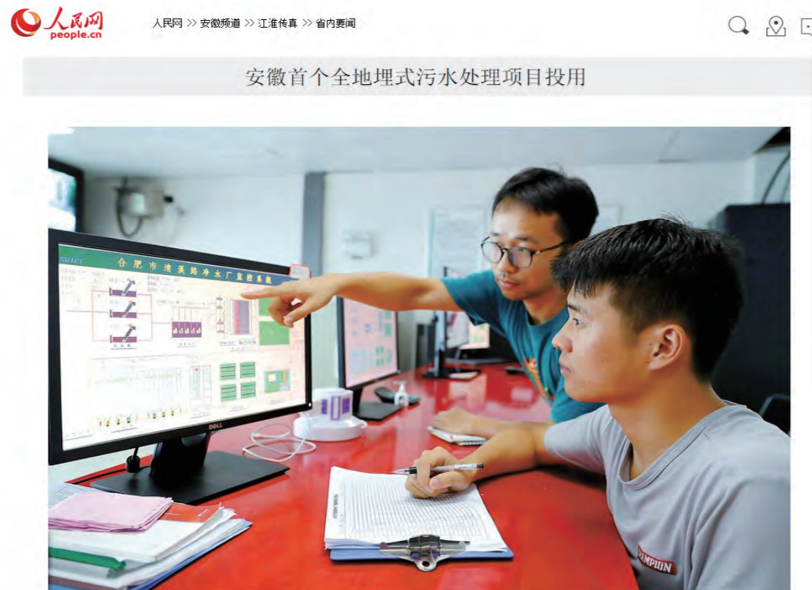
中央控制室内，工作人员在监控系统运行情况。
